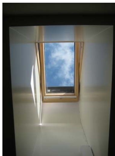
Figuur 4: Dakraam op 2e verdieping ten behoeve van zomernachtventilatie
